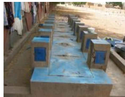
Compteurs à eau, Burkina Faso, Photo IRC
